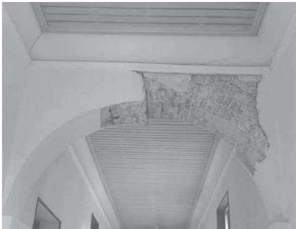
平成二十八年熊本地震で大きなひび割れが生じた五高記念館の二階廊下のアーチ部分
